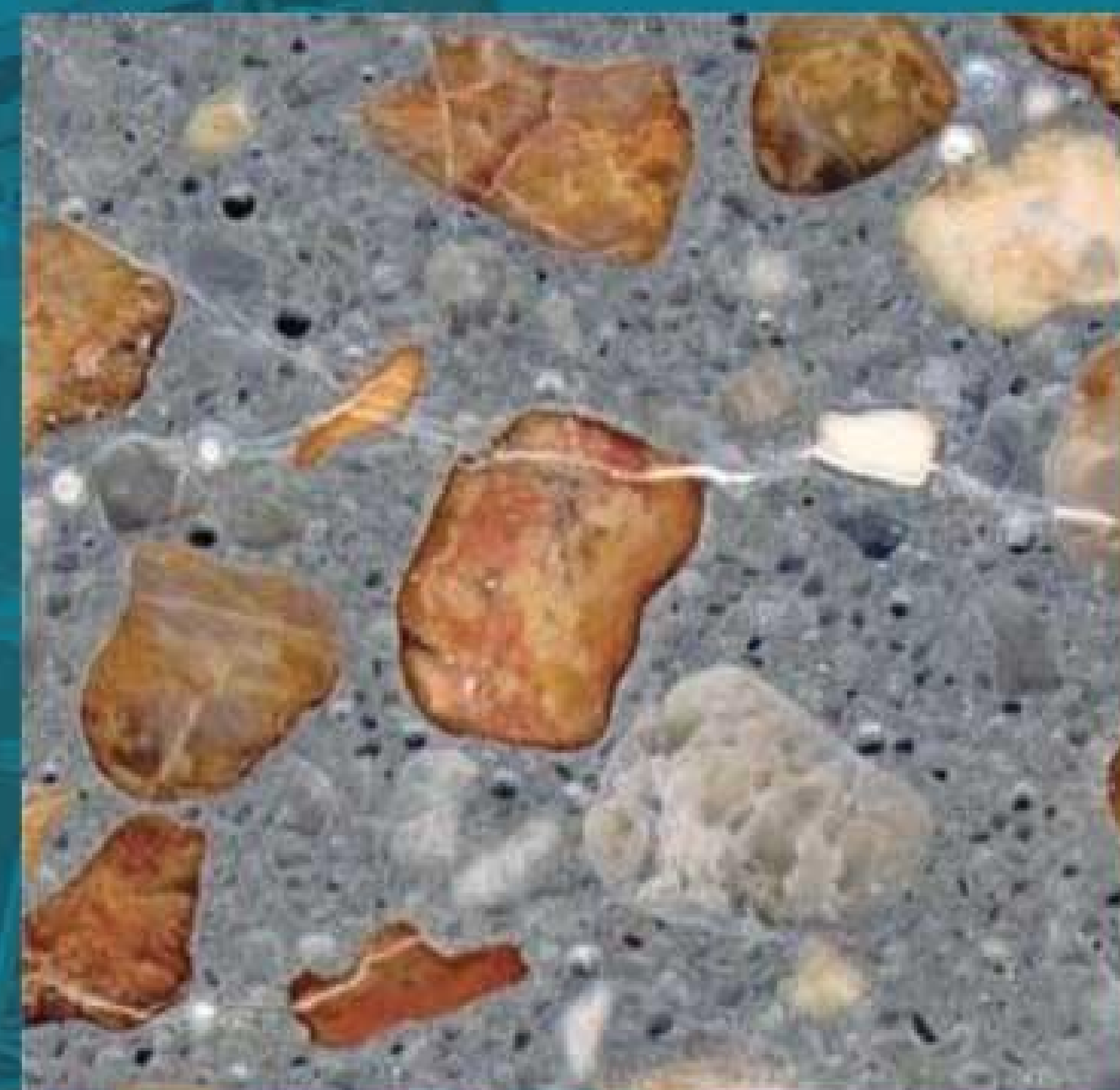
شکل ۲- ترک خوردگی در بتن به دلیل انبساط حاصل از واکنش قلیایی سیلیسی
